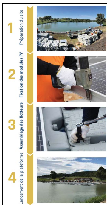
Figure 24 : Etapes de la construction de la centrale (Source : Ciel & Terre, fournisseur de flotteurs)
